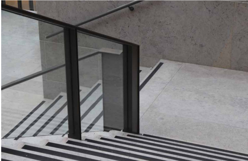
Figuur 1 — De ad hoc aangebrachte trederandmarkering blijkt een goede oplossing om het valrisico bij de entree van het Rijksmuseum permanent te verkleinen.
